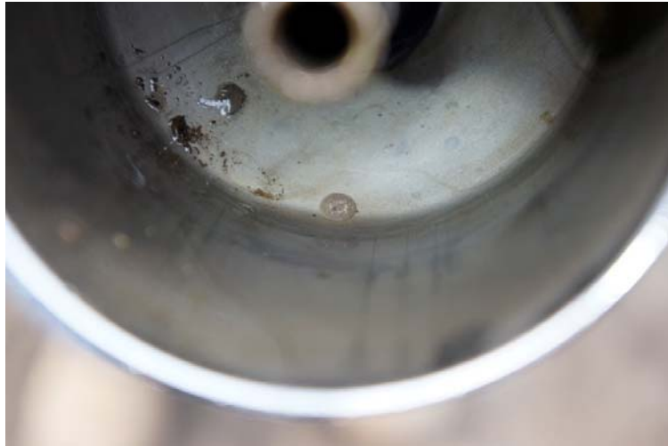
Fotografía No. 17 Presencia de agua y sedimentos dentro del vaso del filtro.
