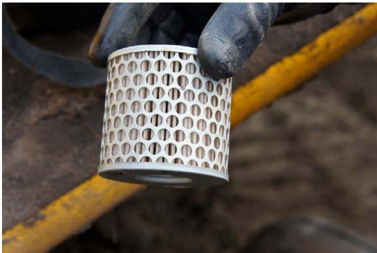
Fotografía No. 16 Vista cercana del filtro de combustible sin contaminantes sólidos.
