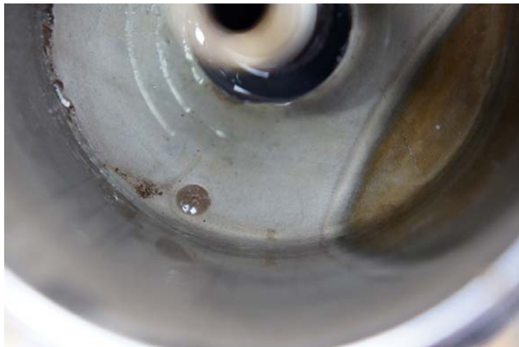
Fotografía No. 18 Presencia de agua y sedimentos dentro del vaso del filtro.
